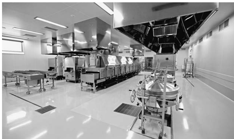
揚げ・焼物室
